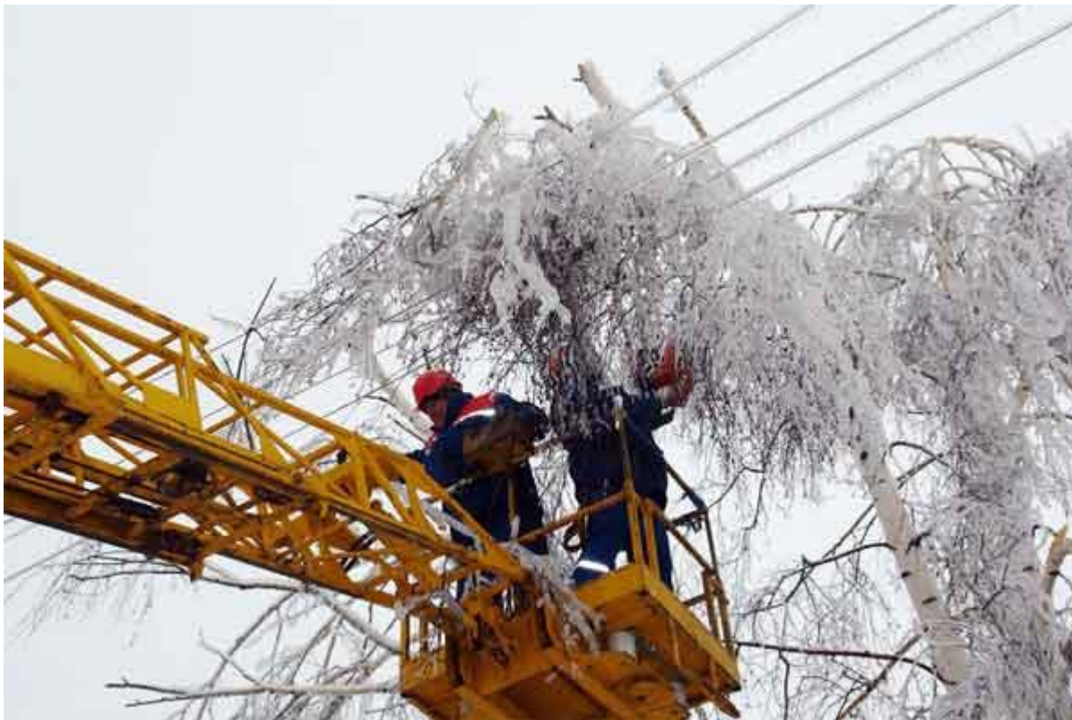
Рисунок. Устранение аварии на ВЛ, вызванной гололёдными отложениями
